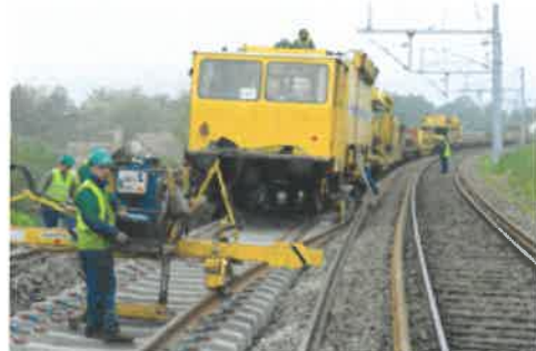
Longs Rails soudés sur traverses béton
